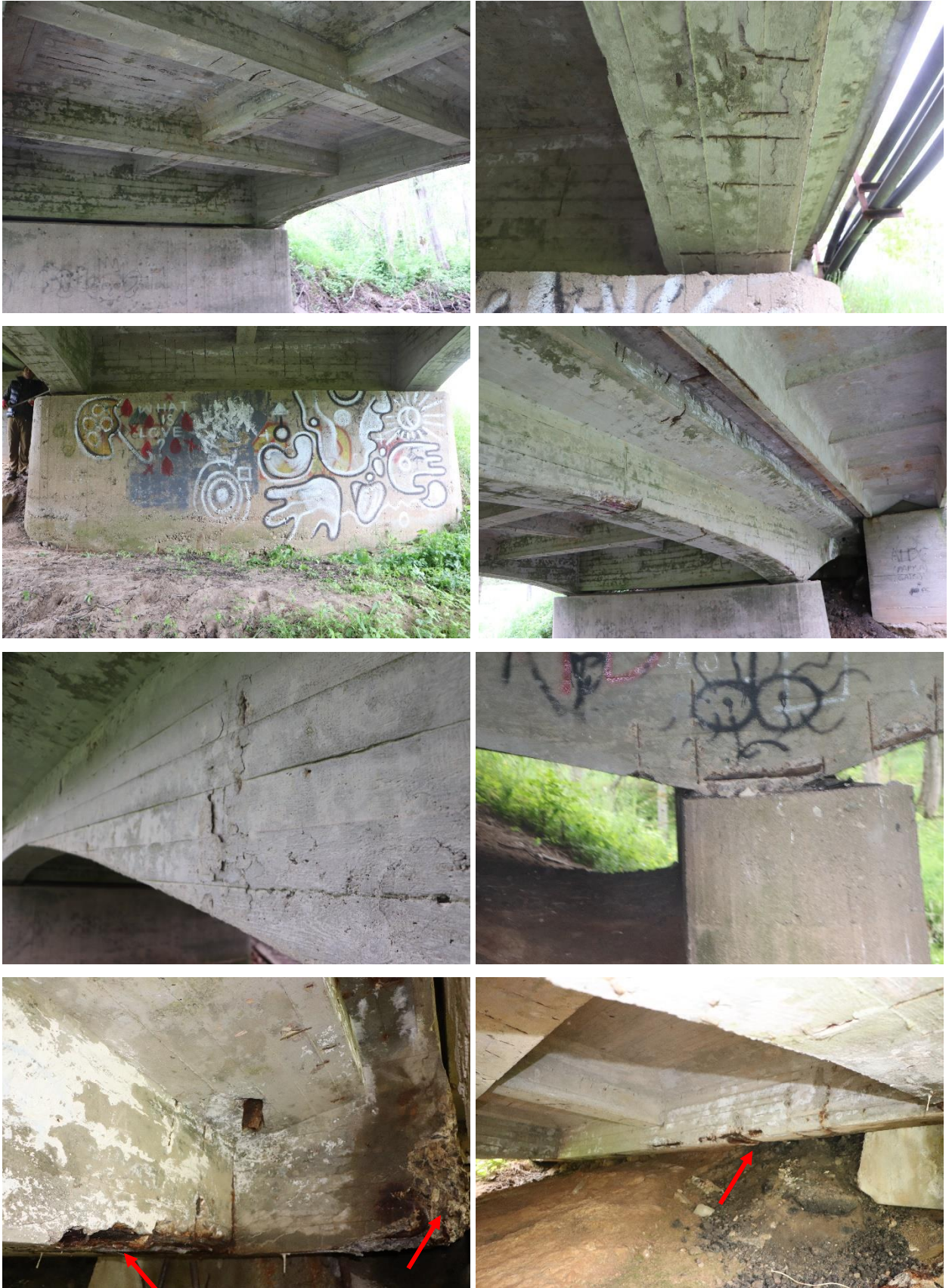
4 pav. Gelžbetoninės perdangos charakteringi defektai: betono ir armatūros korozija, atšokęs ir vietomis per mažas apsauginis sluoksnis, pažeisti perdangos gembių kraštiniai ruožai
