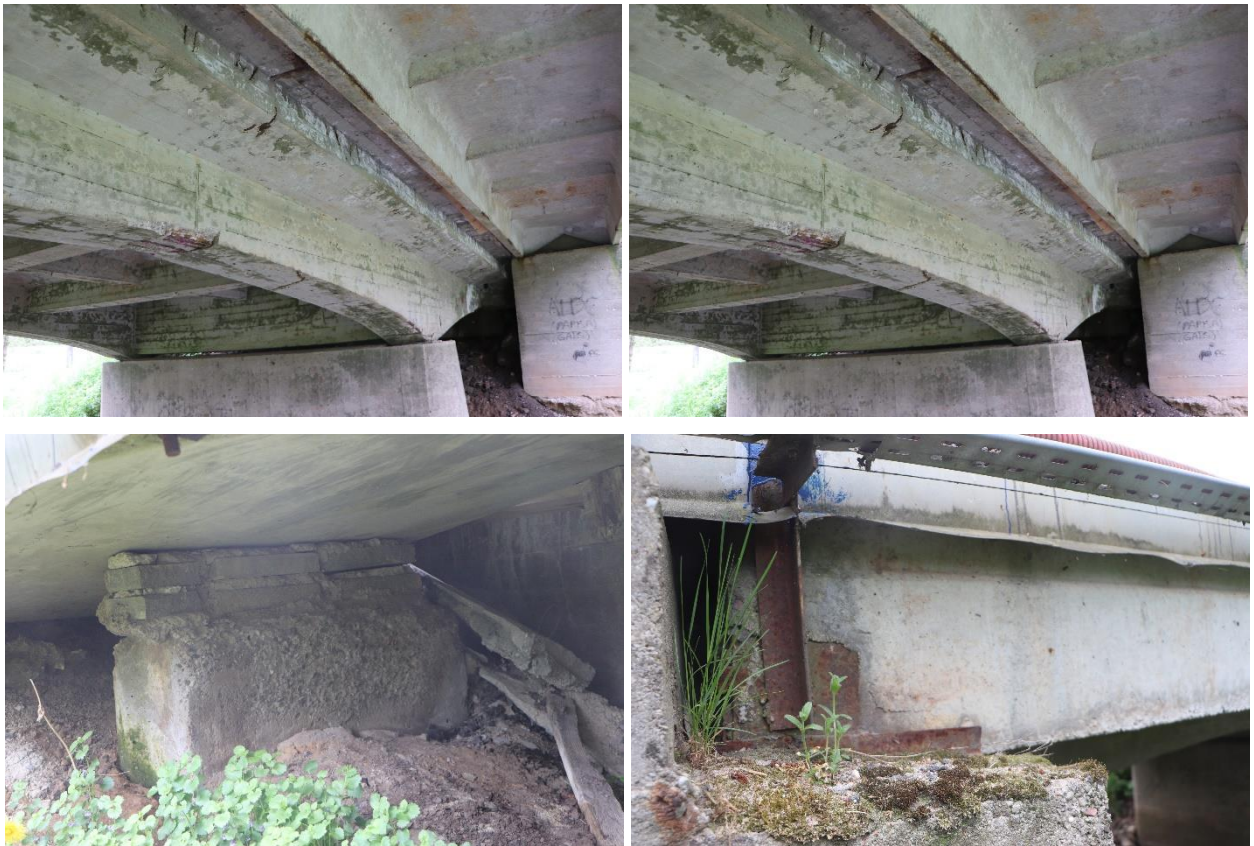
8 pav. Pėsčiųjų ir dviratininkų tako laikančiųjų konstrukcijų defektai
