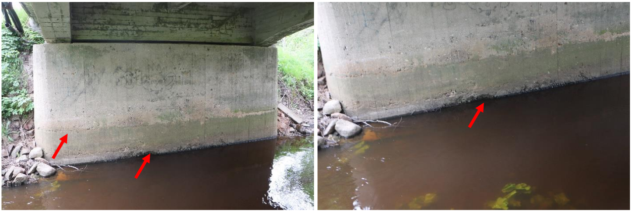
5 pav. Gelžbetoninių atramų charakteringi defektai: porėtas betono paviršius, kavernos sąlytyje su upės vandeniu
