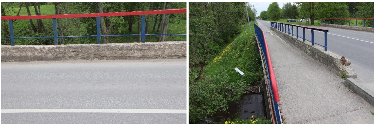
6 pav. Gelžbetoninių atramų charakteringi defektai: porėtas betono paviršius, kavernos sąlytyje su upės vandeniu
